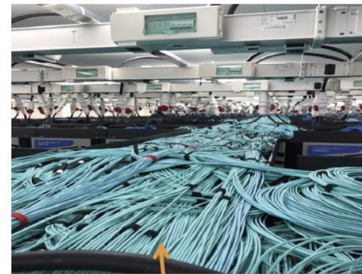
OPA Optic Cables
